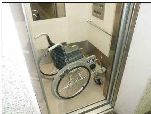
(車いすが転回できないエレベーター)
