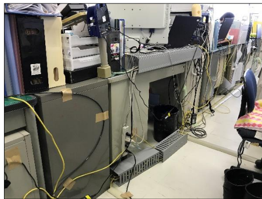
(危険な露出配線)
