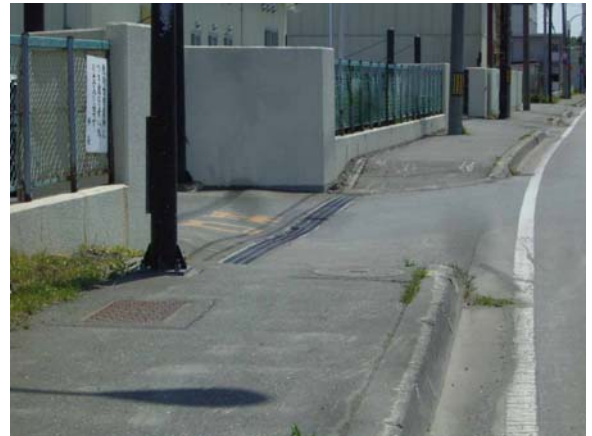
図 歩道の不陸のある場所（副港通）
