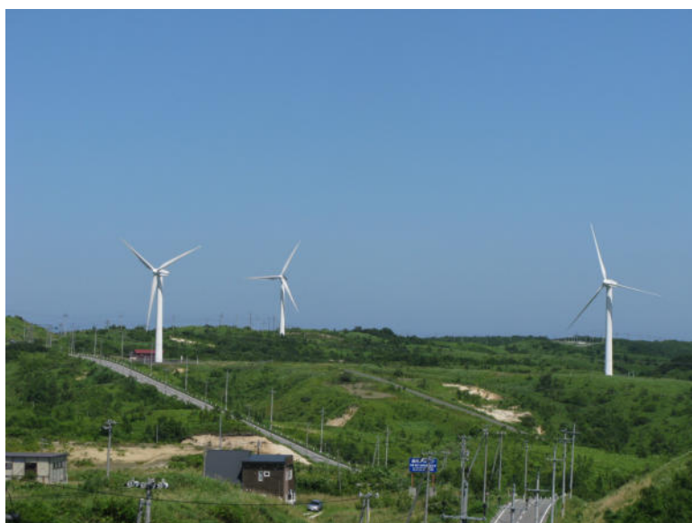
稚内市水道事業風力発電所(660kw×3基)
