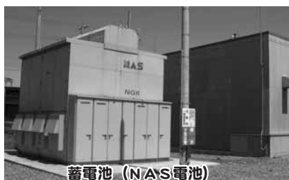
蓄電池（NAS電池） 太陽光発電で電気を充電したり放電したりすることで、送電する電力を調整することができます。
